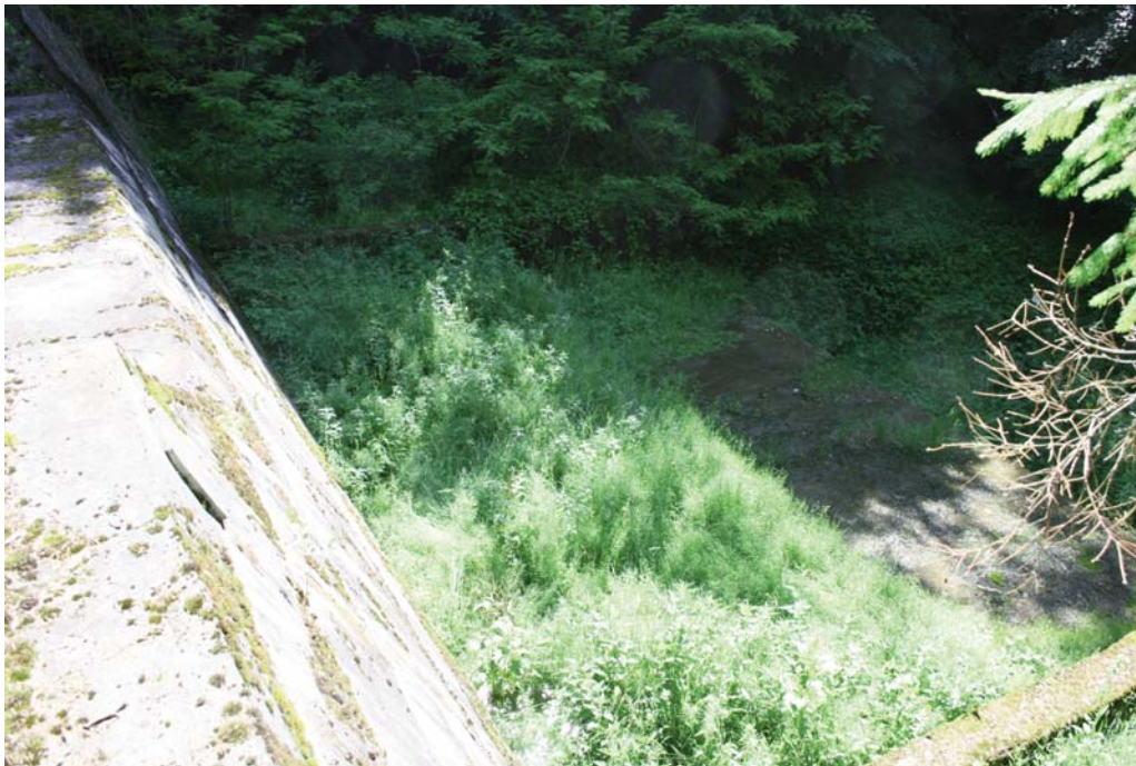
Fig. 6. 40 Colmatarea radierului și instalarea vegetației forestiere pe aluviunile depuse la barajul 17B4 de pe Valea lui Angel (foto: Tudose 2009). Apron clogging by alluvia, followed by the installation of vegetation on dam no 17B4 Valea lui Anghel(photo: Tudose 2009)
