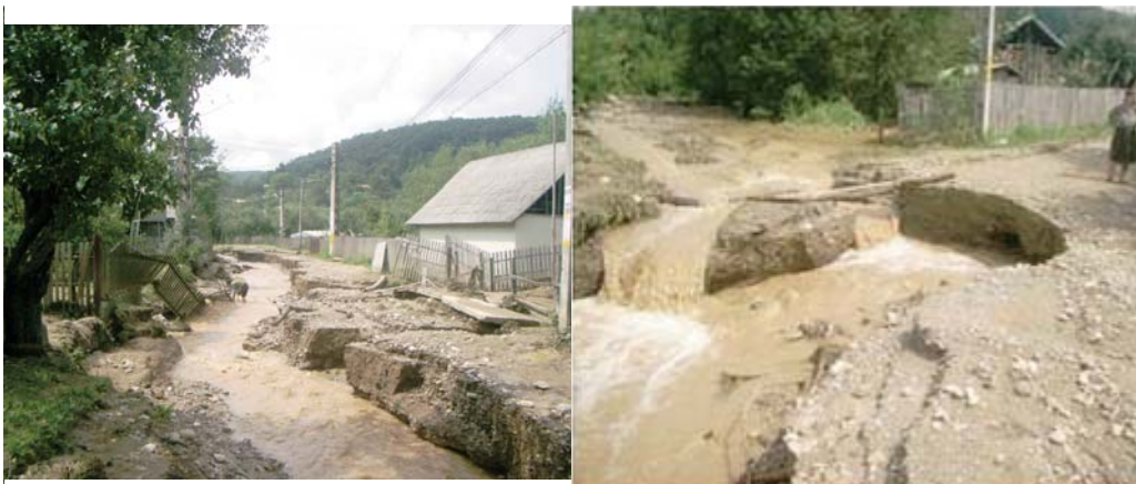
Fig. 2. 2 Drumul comunal al localității Valea Mare (jud. Dâmbovița), din bazinul hidrografic Valea Perilor, afluent al râului Cârčinov, distrus la viitura din anul 2005 (foto: Tudose, 2005). Valea Mare (Dâmbovița county, located on the Valea Perilor hydrographical basin tributary to Carcinov river) main street destroyed by the flood (photo: Tudose, 2005)
