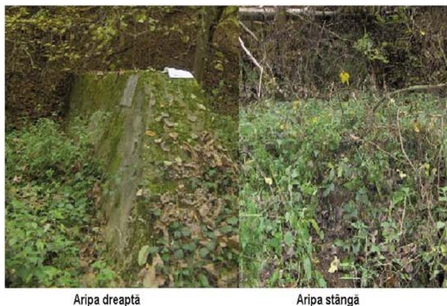
Fig. 6. 47 Scoaterea totală din funcțiune, provocată de evenimentul „îngroparea lucrărilor”, a traversei 8B0 de pe valea lui Șipot (foto: Tudose 2009). Total damage of traverse no 8B0 on Valea lui Șipot caused by the complete burial of works (photo: Tudose 2009)
