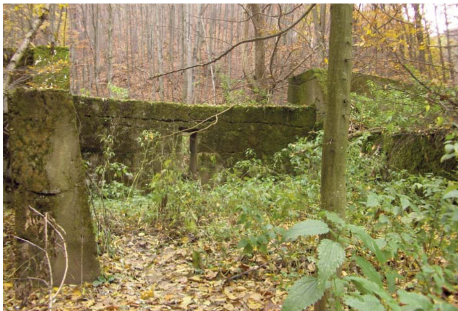
Fig. 6. 21 Barajul 4B2,0 de pe Valea Clăilor prezentând o fisură ușor vizibilă la nivelul corpului zonei deversate (foto: Tudose 2009) Dam no 4B2.0 on Valea Clailor affected by a crack visible at the level of the overspill(photo: Tudose 2009)
