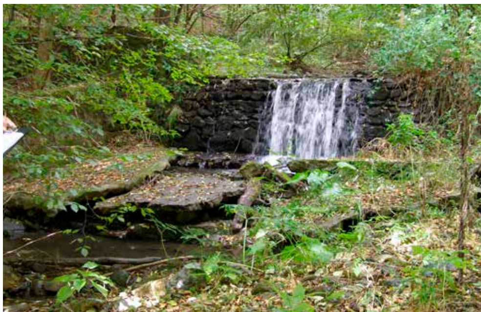
Fig. 4.5. Pragul 30M1,5 de pe pr. Alunului Sadu Gorj (B.H. Jiu), cu radierul avariat (desprindere, eroziune) însă în stare bună de funcționare - Y_s=68,3 , necesitând consolidări (foto David, 2009).
