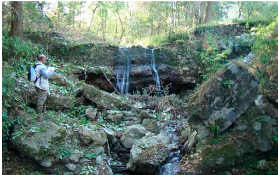
Fig. 4.4. Pragul 140M1,5 de pe valea Obia (B.H. Argeș) a cărui zonă deversată este desprinsă, conducând la un indice de stare Y_s=24,3 -stare rea (foto Tudose, 2011).
