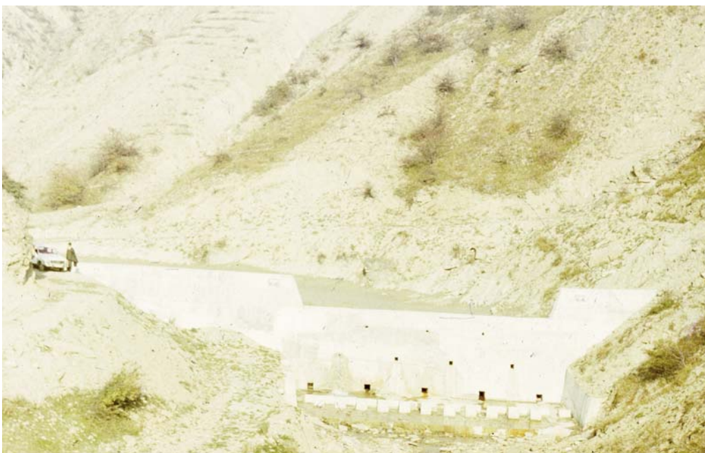
Foto 6.4 a Lucrări de corectare a torențiilor înainte de împădurire în punctul Andreiașu (foto N. Bogdan 1962)
