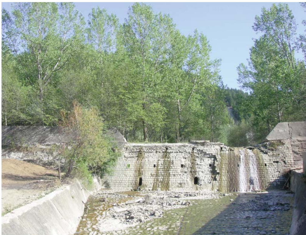
Foto 6.7 b Baraj cu paramentul din aval deteriorat, valea Nărujei (foto C. Constandache, S. Nistor, N. Bogdan 2012)
