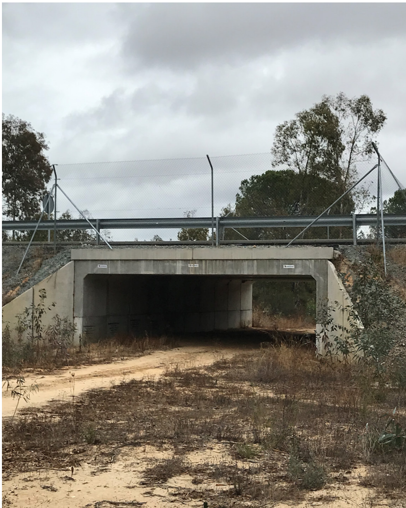
Exemplu de pasaj subteran cu gard de protecție instalat în Donana National Park – Spania (original)
